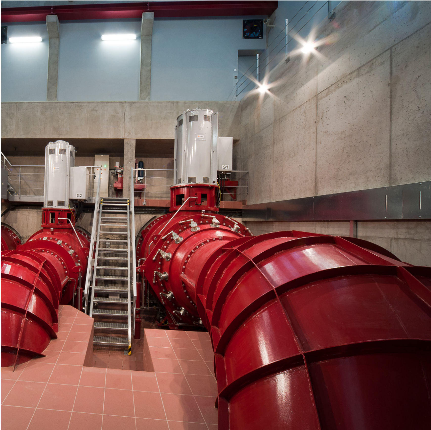
Strojovna malé vodní elektrárny
