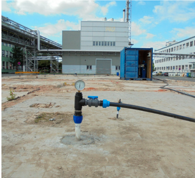
Zařízení na čištění půdního vzduchu
