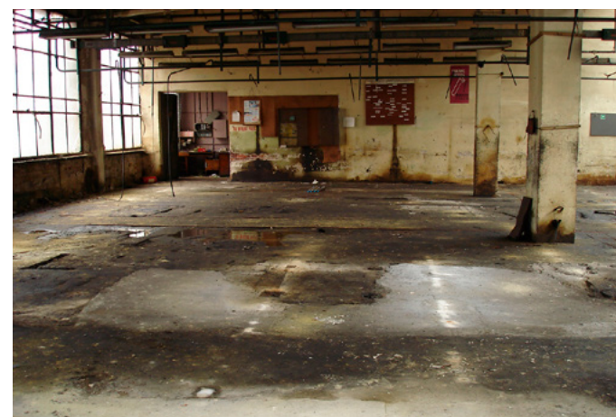
Kontaminace stavebních konstrukcí únikem ropných látek z obrábění
